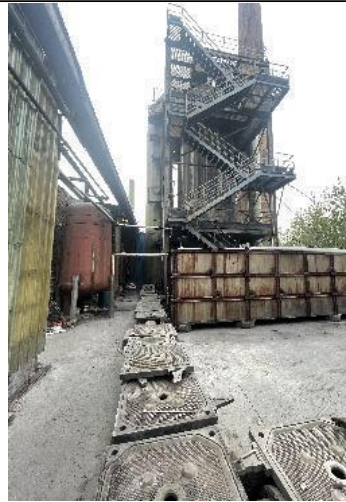
脱硫塔、DA003 排气筒
